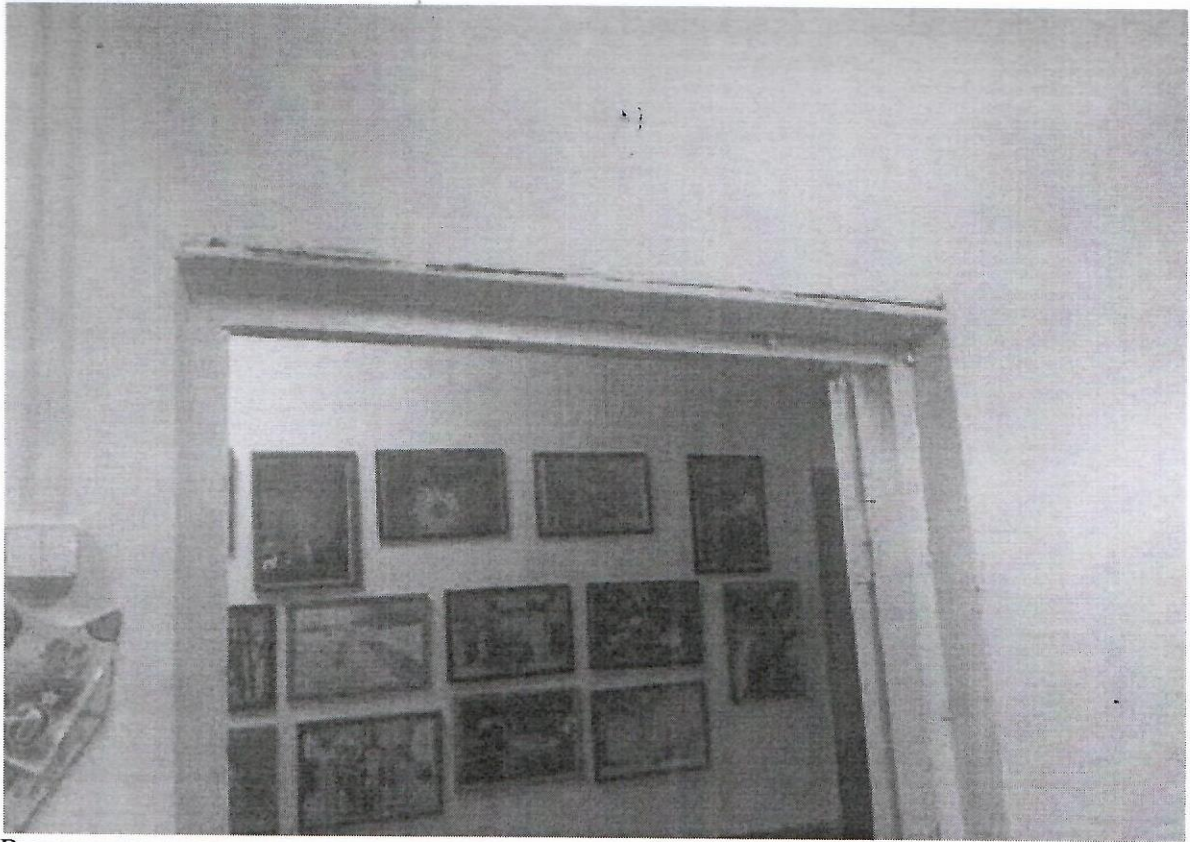
Внутренние и наружные двери имеют повышенный износ.
