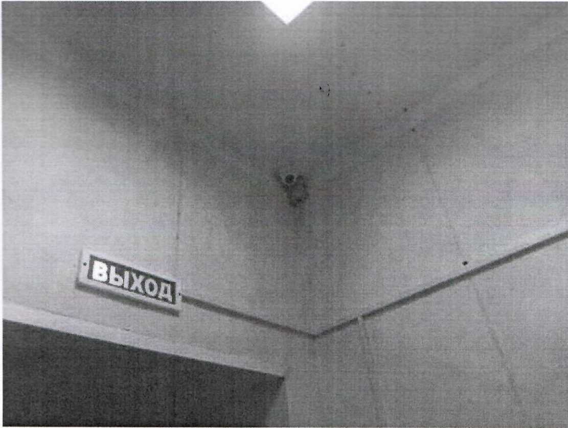
В коридоре 1-го этажа обнаружены следы намокания стены и плесени
