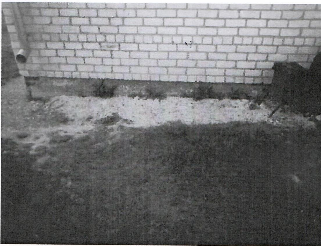
1. Отмостка здания разрушилась.
