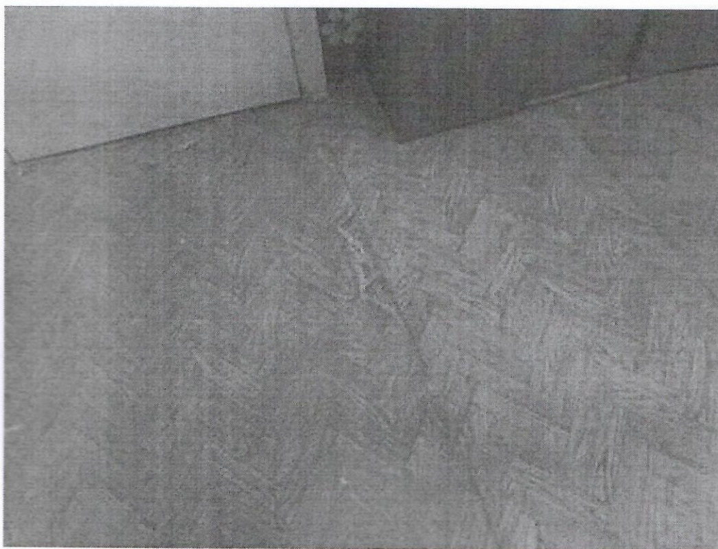
Отделочное покрытие пола в части помещений имеют повышенный износ.
