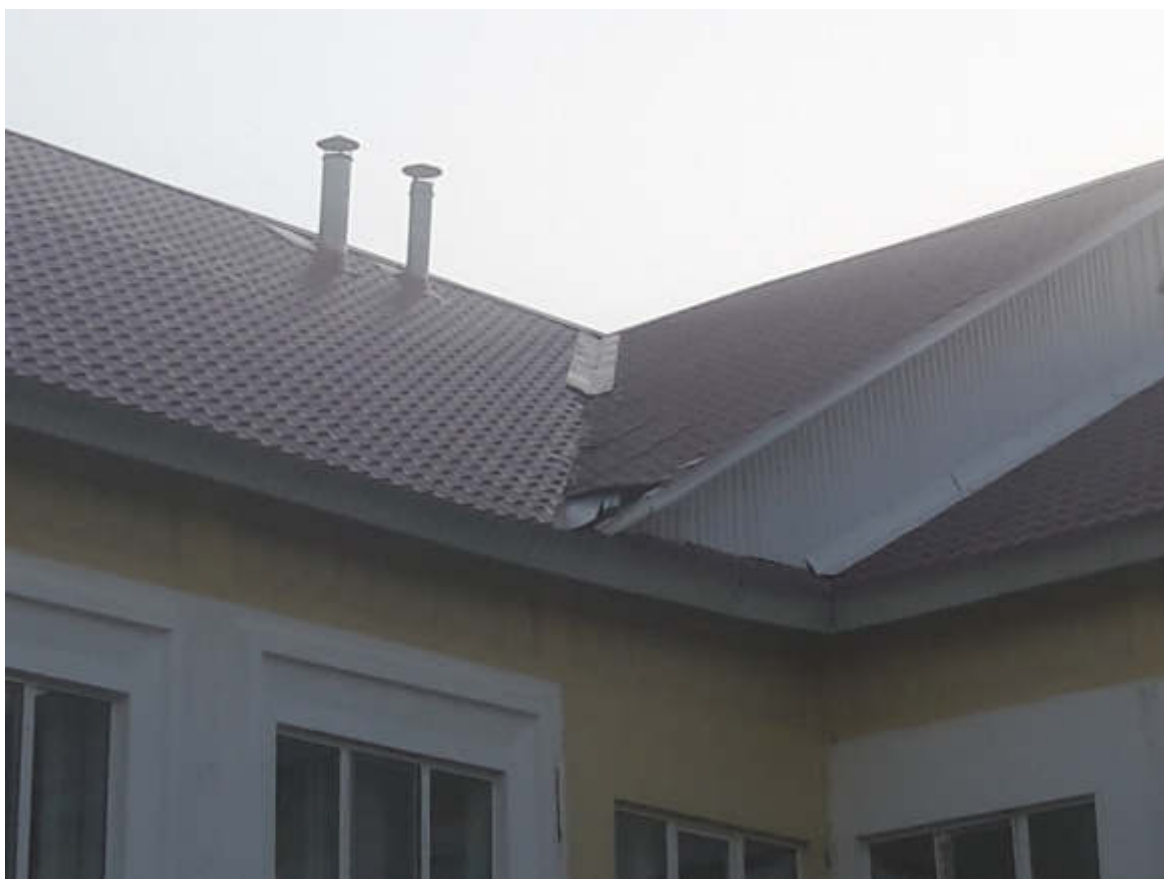
Ветром сорвало конструкцию ендовы., частично повреждена кровля
