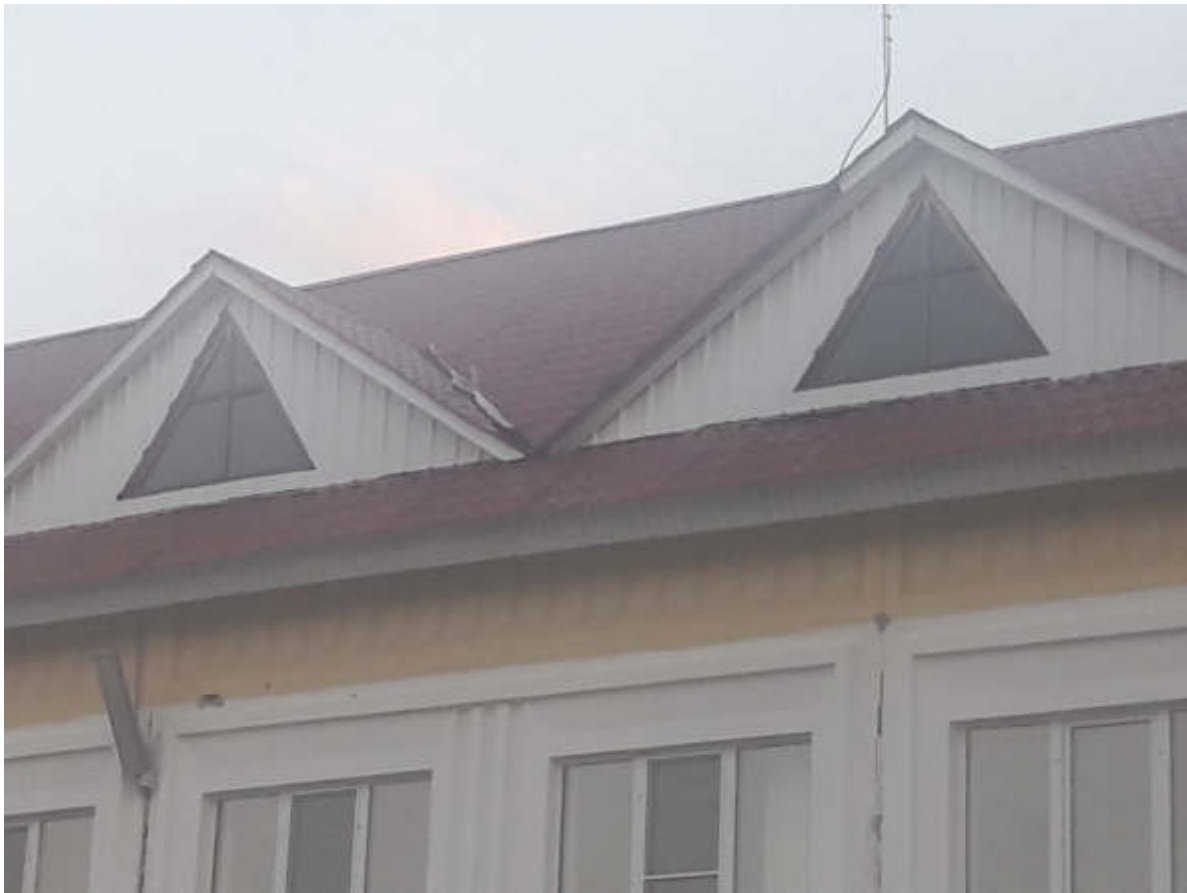
Повреждена конструкция ендовы, частично отсутствует ветровая планка.
