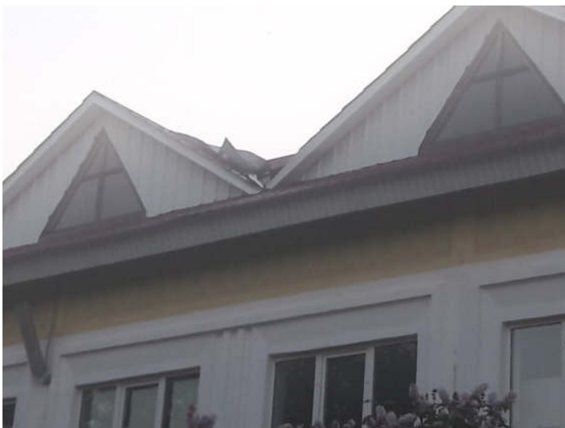
Повреждения конструкции ендов.
