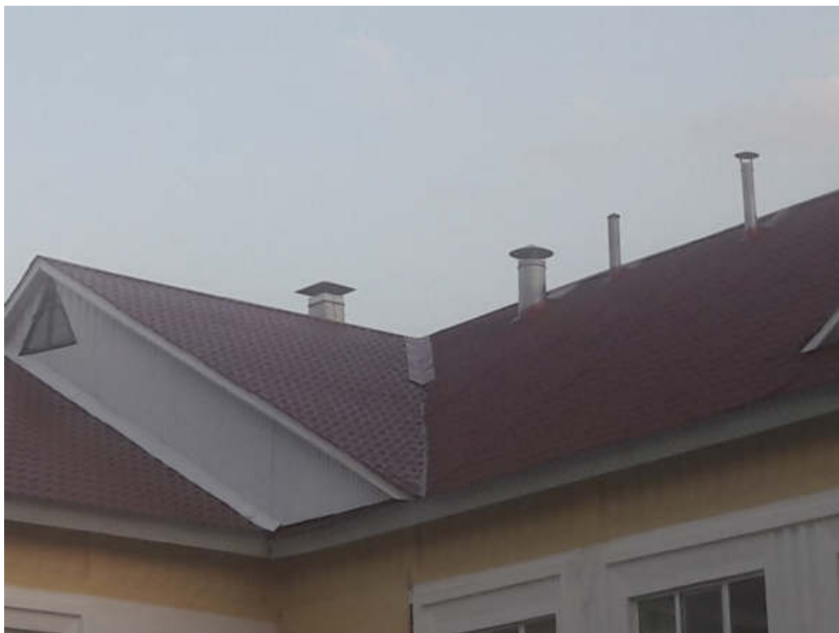
Ветром сорвало конструкцию ендовы.
